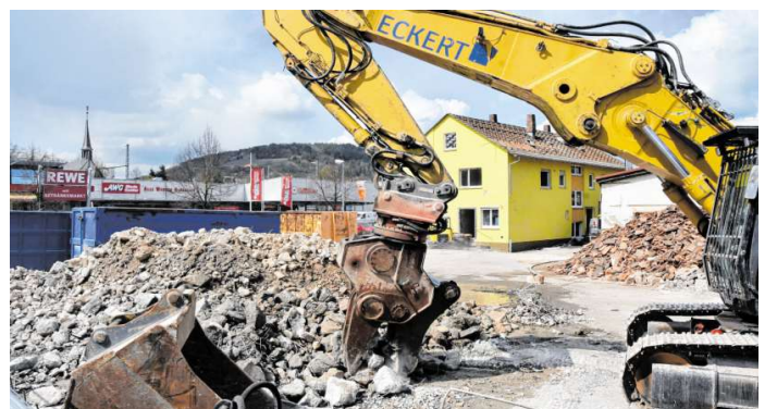
Mit dem Abriss einer Halle im rückwärtigen Bereich beginnen die Arbeiten am Südfleischgelände in der Tauberstraße in Lauda. Anfang Juni soll die Maßnahme beendet sein, im Spätsommer kann die Errichtung der Neubauten starten. BILDER: DIANA SEUFERT
